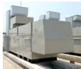
自家発電装置
